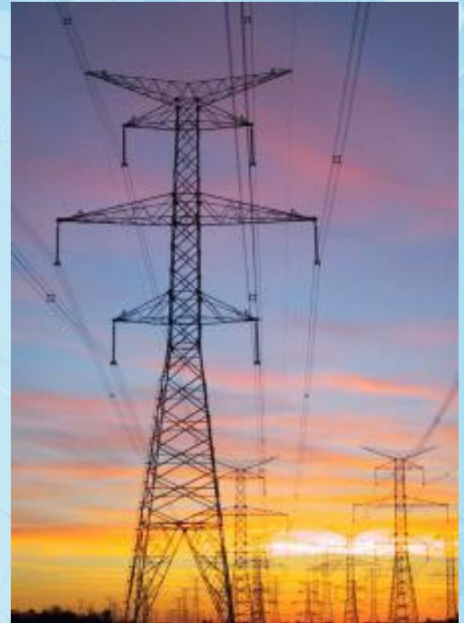
Líneas de Transmisión
